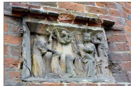
Diese Sandstein-Figurengruppe an der Außenfassade der Marienkirche soll als nächstes Projekt in Angriff genommen werden.
