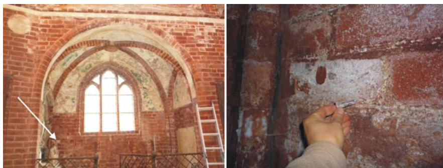
Abb. 9: Ausblühung an der Rückwand der Seitenkapelle, Südwand des Kirchenschiffes
