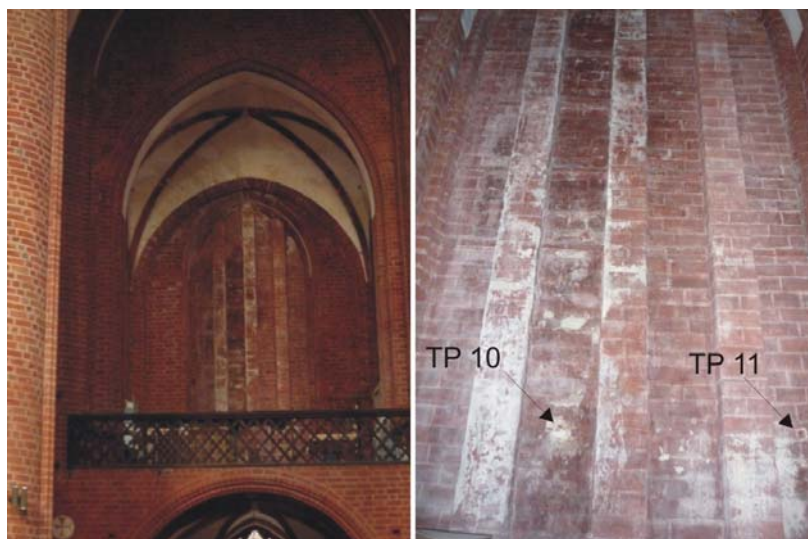
Abb. 11: Belasteter und geschädigter Bereich an der Nordseite des Kirchenschiffes, oberhalb der Empore; Lage der Tiefenprofile TP 10 und TP 11
