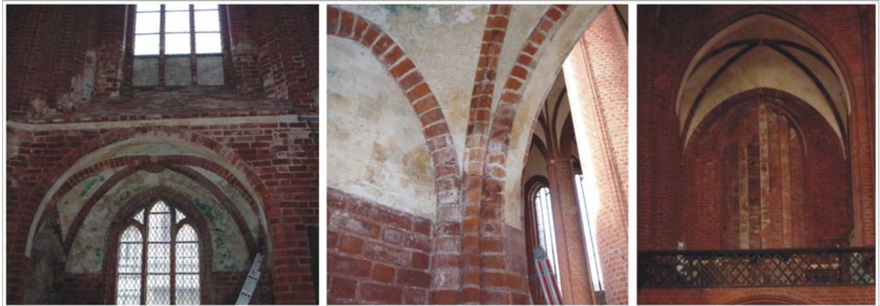
Abb. 1: Ausblühungen in verschiedenen Bereichen im Inneren der Kirche
