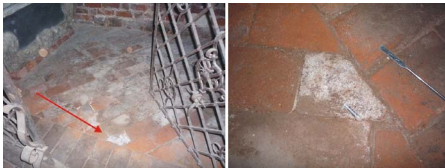
Abb. 8: Ausblühung am Fußboden der Seitenkapelle, Südwand des Kirchenschiffes
